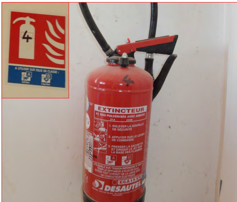
Réfectoire et bennes de stockage temporaire des déchets triés (2 extincteurs) Extincteur eau pulvérisé avec additif 6 L Classes A et B
